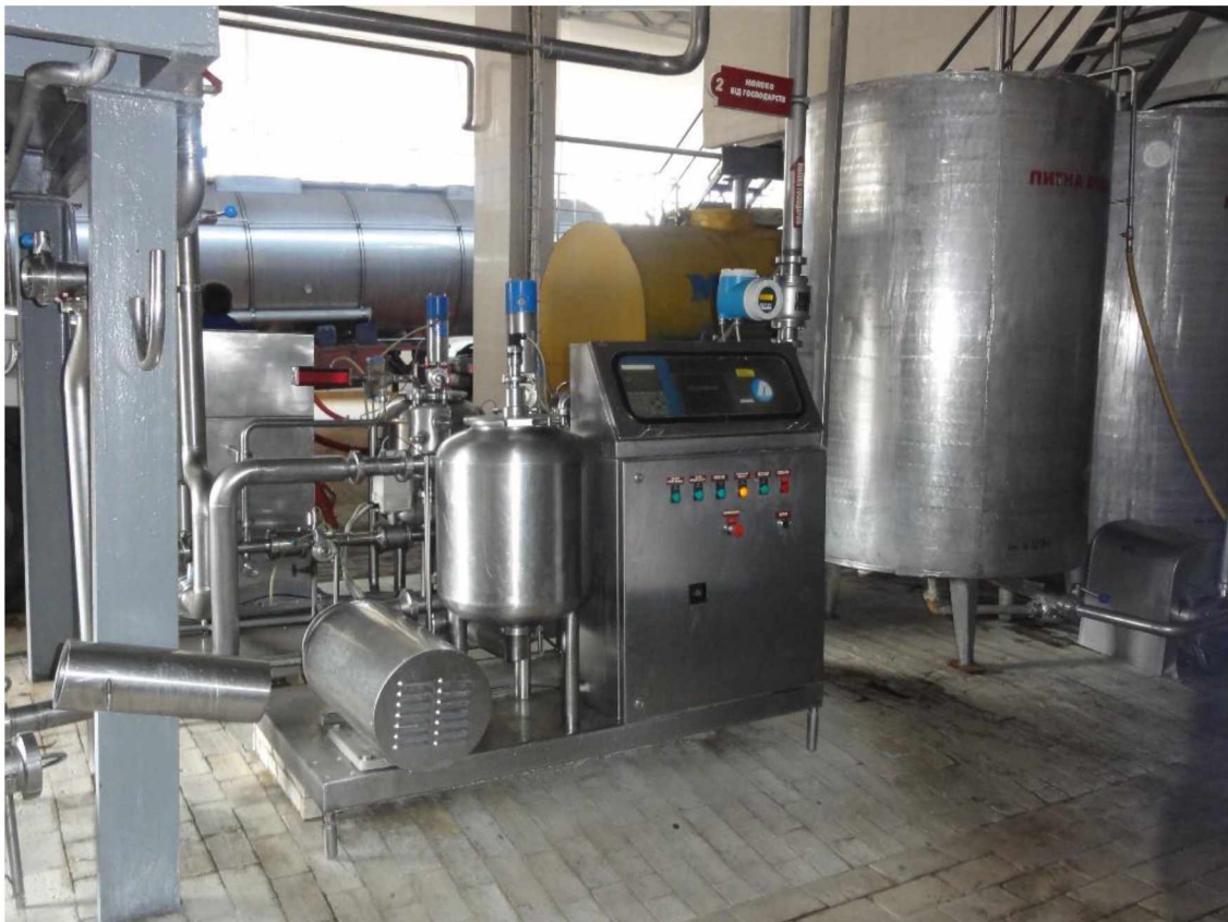
Рис. 3.2. Обладнання приймального відділення
