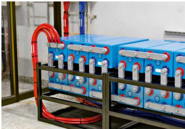
Рисунок 1.2 – Акумуляторна батарея великої ємності в системах безперебійного живлення (UPS) або резервного електропостачання
