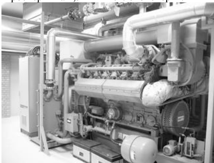
Рис. 8. Когенераційна станція компанії «Зорг Біогаз»
