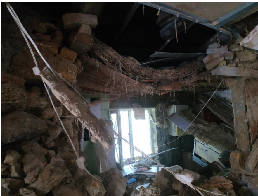
Рисунок 1 – Обвал перекриття житлового будинку в передмісті Херсону внаслідок підриву Каховської ГЕС
