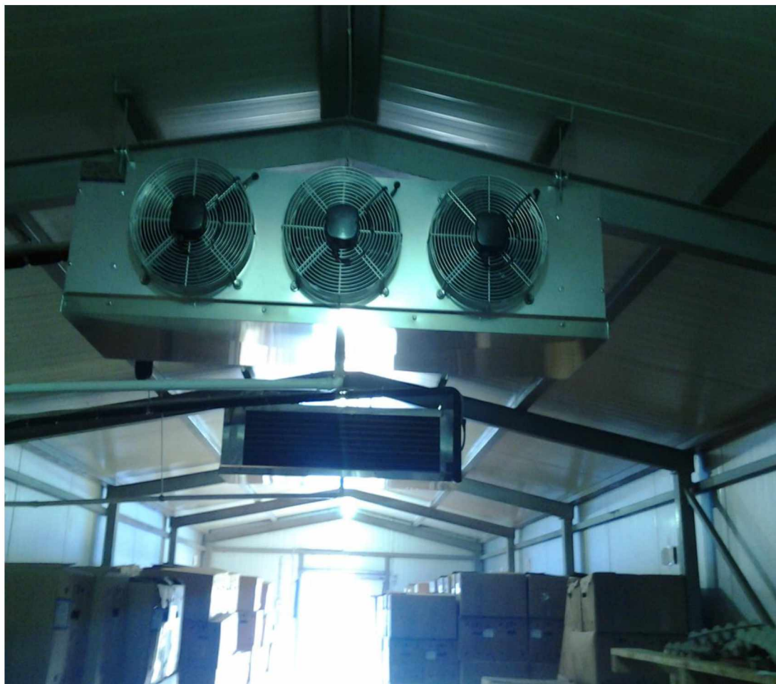
Рис.3.15. Система вентиляції на яйцескладі підприємства
