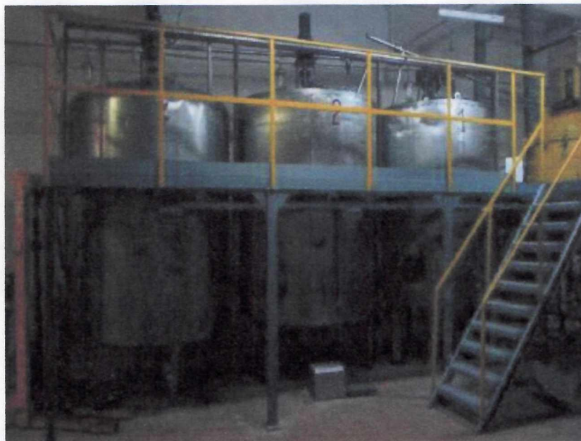
Рис 3.7. Резервуари для сквашування Я1-ОСВ-6
